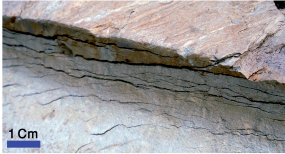
الشكل رقم (١١). ضعف وتدهور حالة الحجر وظهور العديد من الشروخ الدقيقة (micro cracks).
