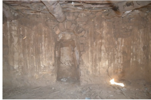
شكل رقم (٣٦) يوضح تساقط طبقات الملاط وتشوه سطحها، نتيجة ذوبان الطفلة وانتفاشها. "من تصوير الباحث".
