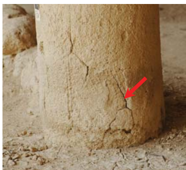
الصورة رقم (١٥). الجزء السفلي من عمود آخر يوضح شروخاً وتفككاً في ملاط الطين بسطح العمود.
