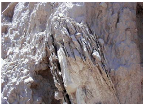
الصورة رقم (٣٩). التفتت السطحي لأحجار البناء.
