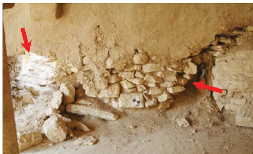
الصورة رقم (١٣). صورة مقربة للجزء السفلي من الجدار الجنوبي من المسجد توضح تآكل طبقة الملاط وتفكك مداмик الأحجار السفلية بالجدار مع تكون فتحات نافذة بأسفل الجدار.
