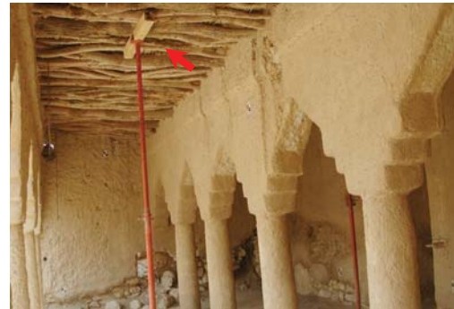
الصورة رقم (١٠). مصابيح المسجد من الداخل ويظهر الحالة المتدهورة لطمائم السقف من جذوع الأثل وتلف الجدران.
