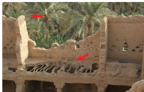
الصورة رقم (١٩). تهدم جدران الطابق الأول بالجانب الشرقي من السبالة وتساقط معظم الكسوة الطينية للسقف مع ميل الجدار الأيسر.
