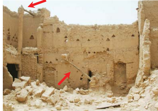
الصورة رقم (٢٥). انهيار معظم أجزاء منطقة الإيوان الجنوبي بالسبالة وميل بعض الجدران، وأعمدة الطابق الأول حرة من أعلى لسقوط السقف. وانهيار السلم المؤدي للطابق الأول.
