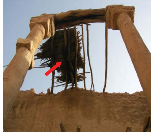
الصورة رقم (٢٣). انهيار معظم السقف الخشبي فوق المنطقة الشرقية من السبالة مما يجعل الأعمدة حرة من أعلى (منطقة أخرى بخلاف ما بالصورة رقم ٢٣).
