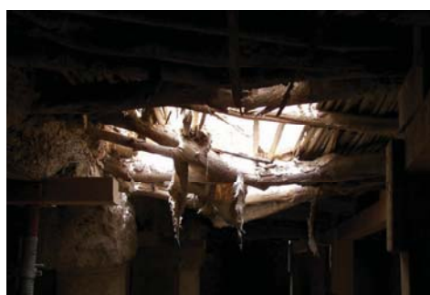
الصورة رقم (١٦). انهيار جزئي بسقف خلوة المسجد ودعم باقي السقف.
