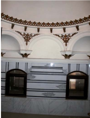
لوحة رقم (١٩). قصر علي باشا بن عون: الطابق الثاني، الحمام، الحجرة الساخنة.
